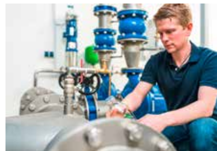
Martin Hirsch entnimmt eine Wasserprobe Foto: Stadtwerke
